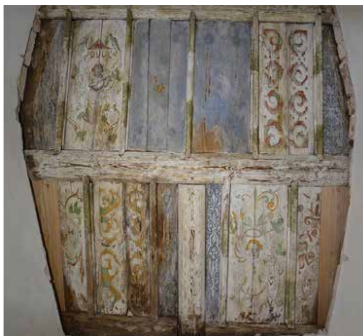
62 Bad Belzig, Gertraudenkapelle, Holzbalkendecke im Chor, Zustand nach Konservierung der Deckenmalerei des frühen 17. Jh., 2016 Foto: U. Drott, Berlin
