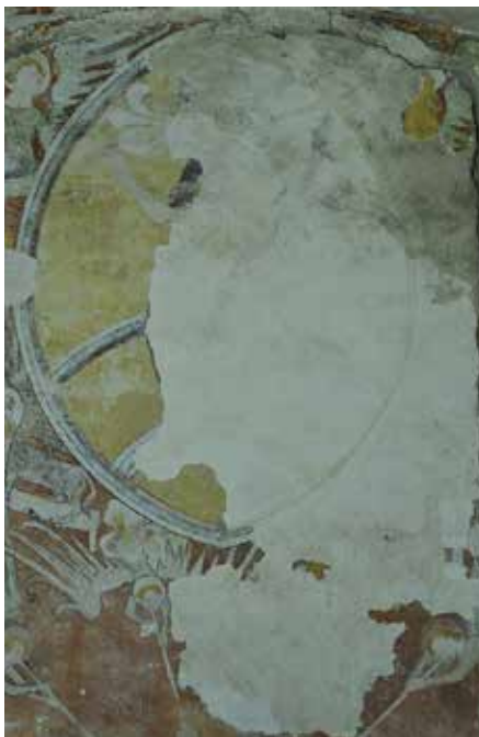
66 Brandenburg, Johanniskirche, Wandmalerei mit „Weltensrichter“-Darstellung, Teilfreilegung in Tageslicht fotografiert, 2016 Foto: M. Noll-Minor, BLDAM
