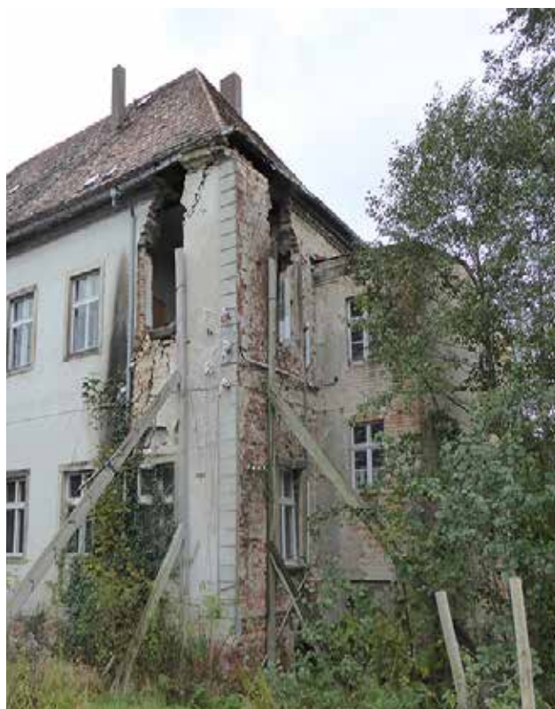
59 Neudöbern, Herrenhaus, statisch instabile Ecke, 2016 Foto: G. Frank, BLDAM
