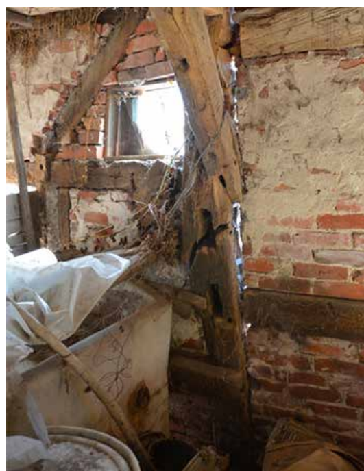
51 Innerhalb des letzten Jahres haben zwei Balken im Gebäude dem Druck nicht mehr Stand gehalten und sind gebrochen Foto: H. Türk, BLDAM
