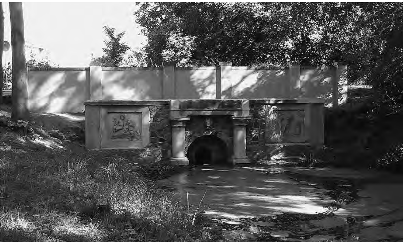
Abb. 15 Steinhöfel, Landkreis Oder-Spree, Schlosspark, Quellfassung, Zustand Juli 2004, Beispiel einer fotografischen Darstellung der gleichen Situation wie in Abb. 10 nach Beendigung der Baumaßnahme
