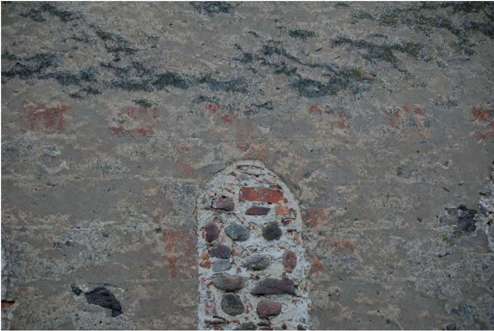
50 Geritzte Putzquaderungen am östlichen Langhaus Bild: Beuth-Hochschule/BLDAM
