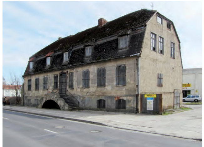
20 Das „Kettenhaus“ in Prenzlau vor der Sanierung im Jahr 2011 Bild: Roland Schneider, BLDAM
