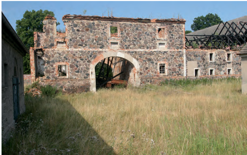
45 Nordfassade des Torhauses nach dem Brand im Jahr 2010 Bild: Dieter Hübener, BLDAM
