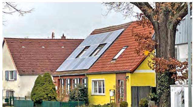
Negativbeispiel: Auch dunkle Module können sich durch Spiegelung stark von der Dachfläche abheben
