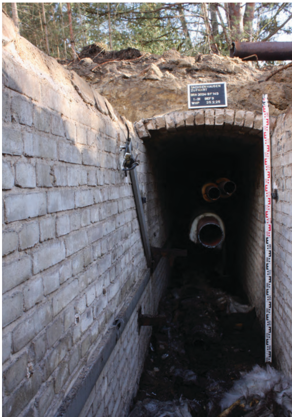
Begehbarer Fernwärmekanal. Foto: J. Weishaupt
