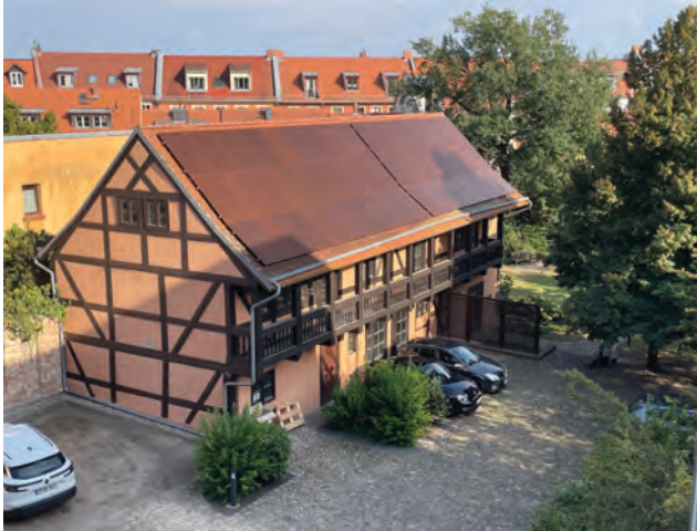
Farblich angepasste Solarmodule auf einem denkmalgeschützten Gebäude. Foto: Andreas Salgo, BLDAM
